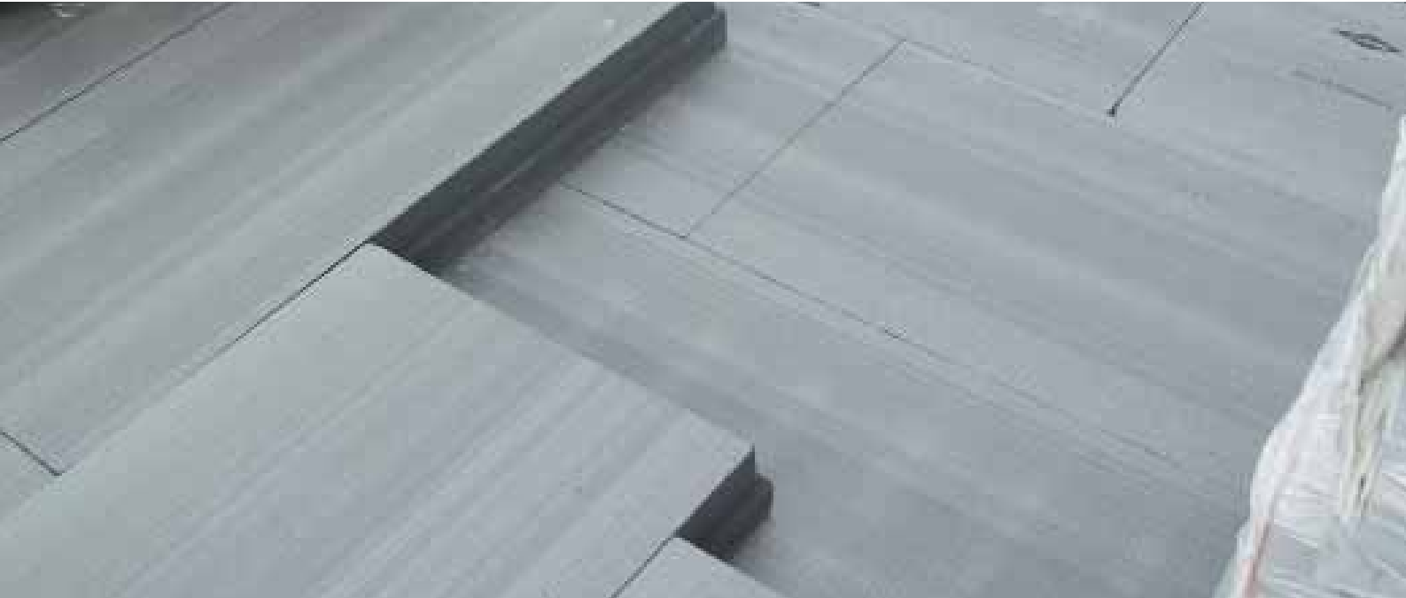
Abb. 18: Zweilagige Verlegung im Umkehrdach mit XENERGY™ (mit bauaufsichtlicher Zustimmung im Einzelfall geregelt)
