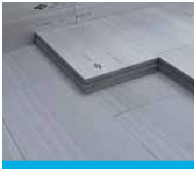
Abb. 21: Zweilagige Verlegung im Umkehrdach mit XENERGY™ (mit bauaufsichtlicher Zustimmung im Einzelfall geregelt) erfüllt die Passivhaus-Anforderung
